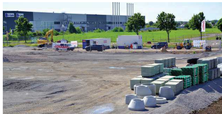
An den „Langen Göhren“ im Gewerbegebiet Sülzetal/Osterweddingen entsteht derzeit ein neuer Parkplatz für Lkw. Das Projekt wird von der Bundesregierung gefördert. FOTO: UDO MECHEINICH
